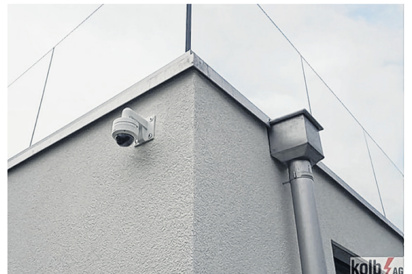
Kamera im Aussenbereich
